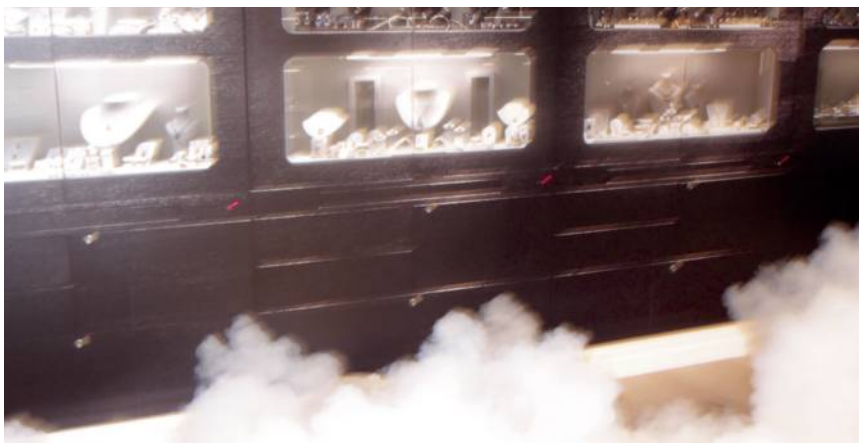
LARMET GÅR. Dimgeneratorn startar.
